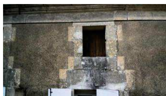
Gros œuvre et structure (fissures)
