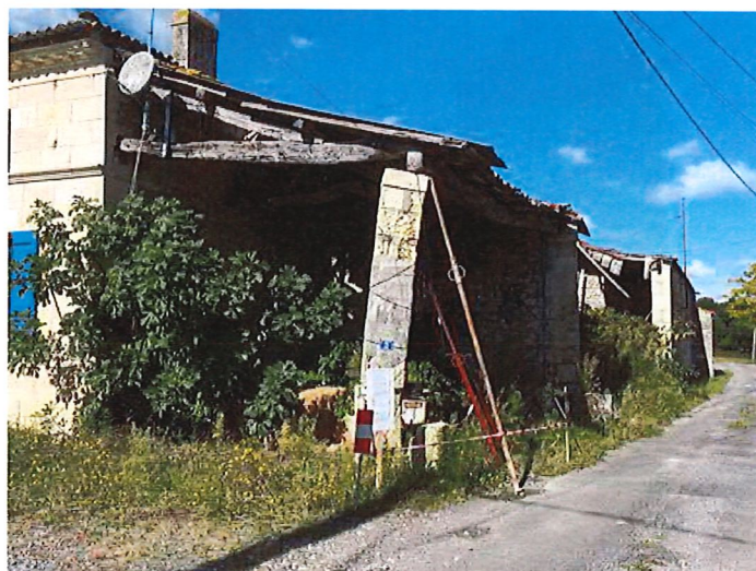
Photo n°1 : 30 09 22 : Etat visuel Auvent 1 avec pilier d'angle défailant
