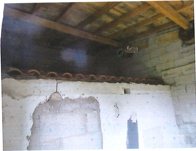
Le local technique avec la machinerie de la piscine.
