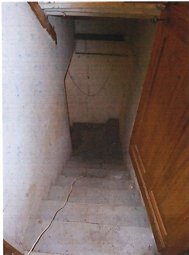
Il s'agit d'une grande cave avec une installation électrique ancienne.
