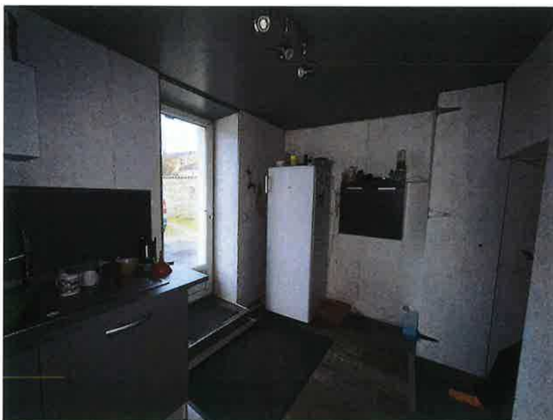
Un placard comprenant un tableau électrique.
