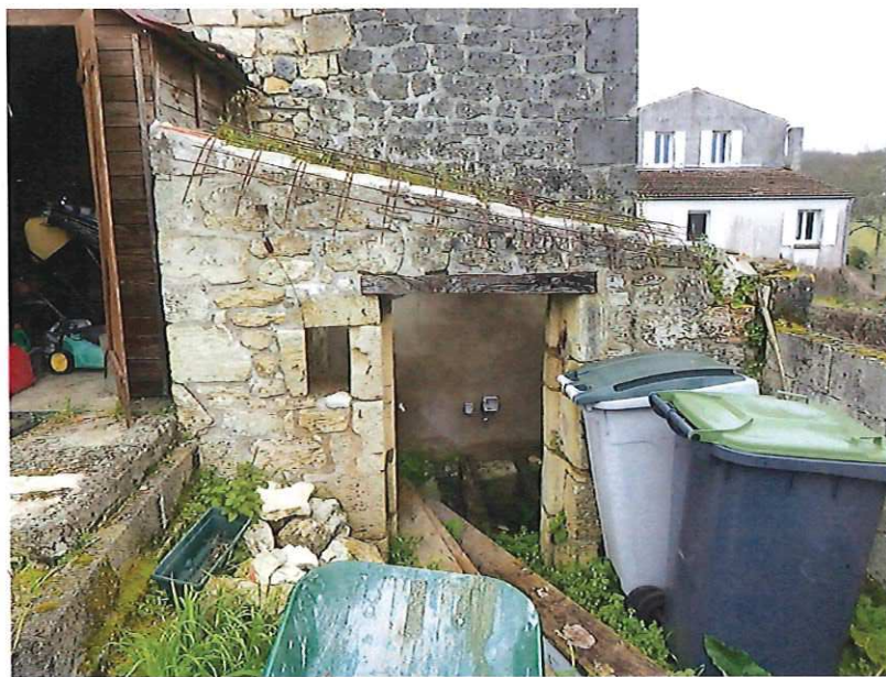
Sur le devant de la maison, il existe une terrasse qui a été coulée sur deux niveaux.
