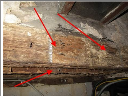
Photo n° Ph001 Localisation : Dépendances - Local P.A.C. Ouvrage : Plafond - Bois nu Parasite : Présence d'indices d'infestation de termites, Termites souterrains Indices : altérations dans le bois
